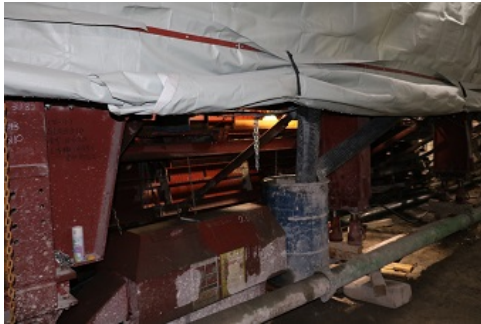
トンネルの覆工に用いられる型枠です。覆工とはトンネルの崩壊と漏水を防ぎ、地山を安全に支持するために行うものです。
