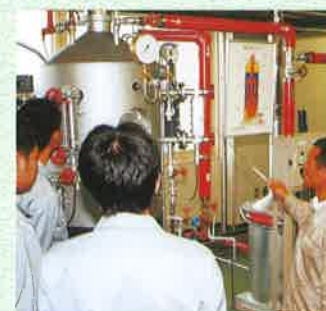
ボイラー運転
